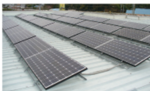
屋上で123枚の太陽光が毎日発電中
