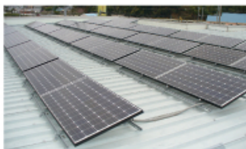
屋上で123枚の太陽光が毎日発電中
